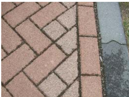
Permeable belægningssten, hvor regnvand kan trænge igennem. Fra et nyt boligområde i Amsterdam.
